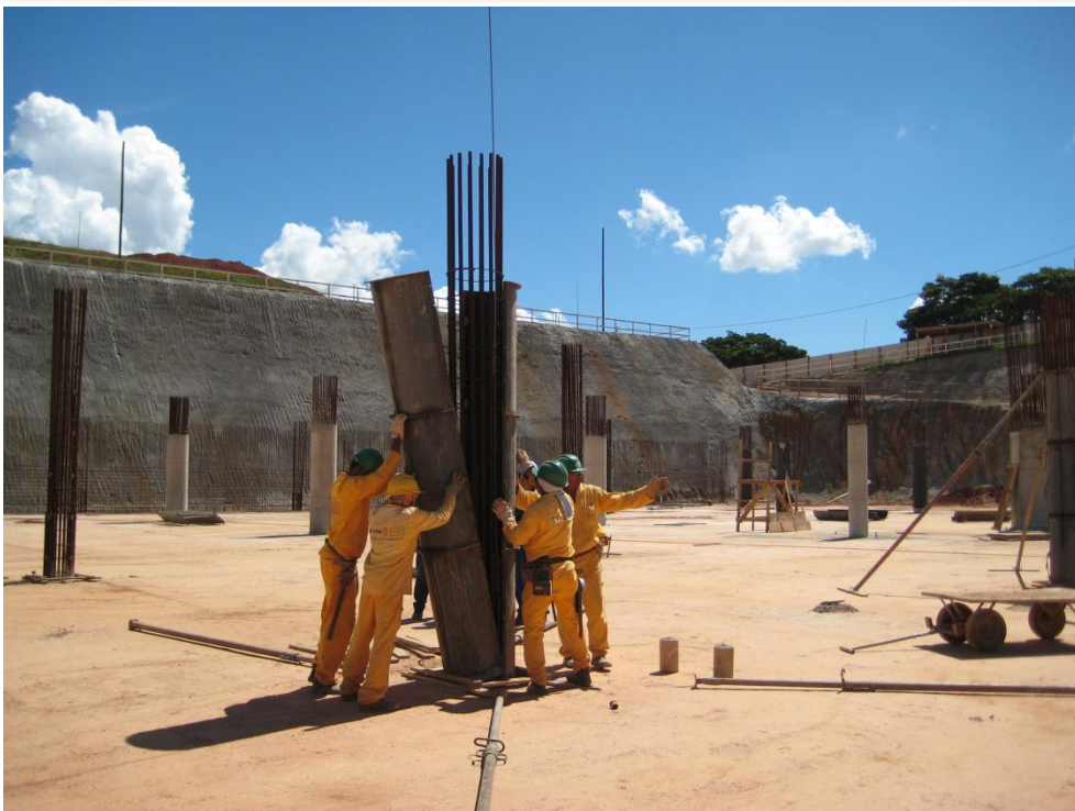
Foto 10 – Forma circular Pilares 3º subsolo, trecho I- eixos 3 e 8, ref. Item 03.02.110.1.01 no Memorial descritivo
