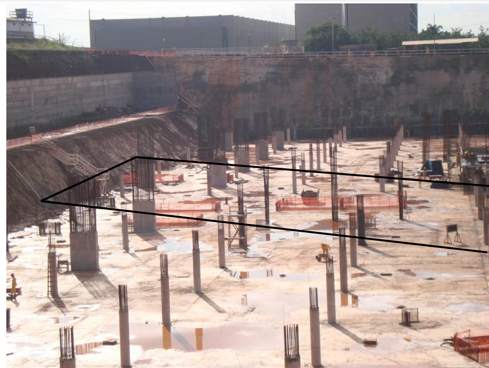
Foto 21 – Concreto Pilares circulares 3º subsolo, trecho II, ref. Item 03.02.700 no Memorial descritivo
