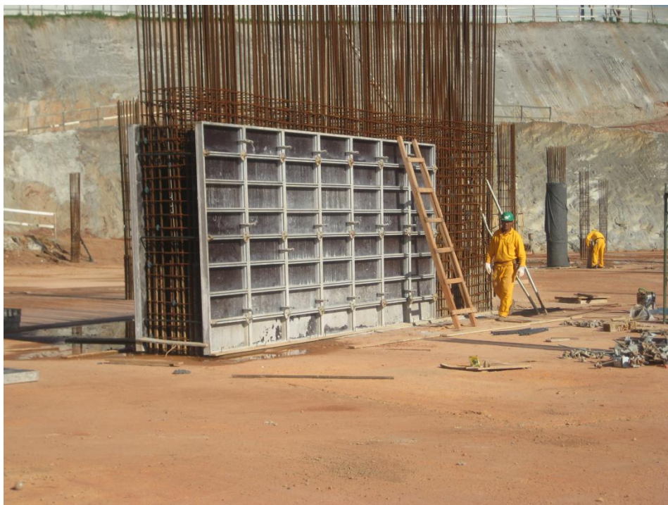
Foto 8 – Forma plana Pilares 3º subsolo, trechos IV- entre eixos 8 e 12, ref. Item 03.02.110.1.01 no Memorial descritivo
