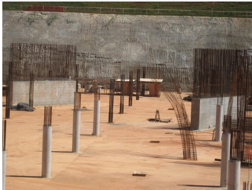
Foto 17 – Aço vertical do nível 1046,325 ao 1049,50 dos pilares retangulares entre os eixos 8-11 e Q-U trecho VI, ref. Item 03.02.500 no Memorial descritivo
