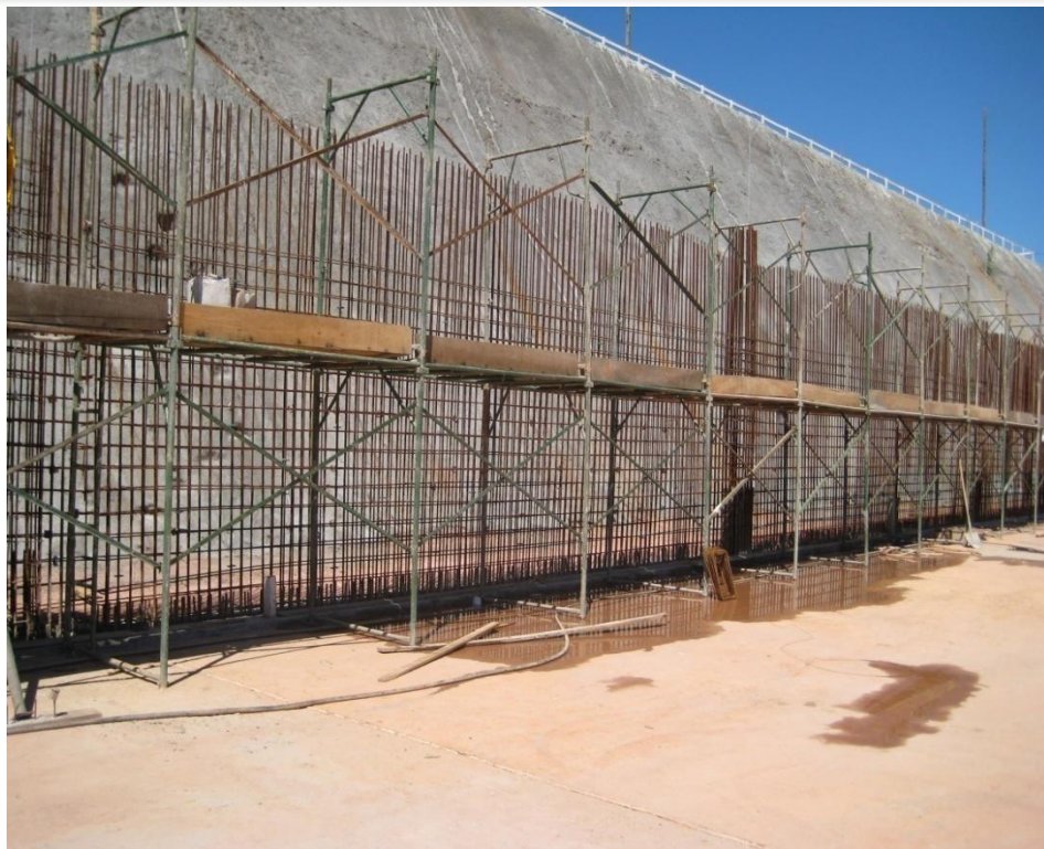
Foto 4 – Aço Horizontal da parede(cortina) do eixo 14 do nível 1045 ao 1046, do eixo B ao V - trechos IV,V e VI, ref. Item 03.01.600 no Memorial descritivo
