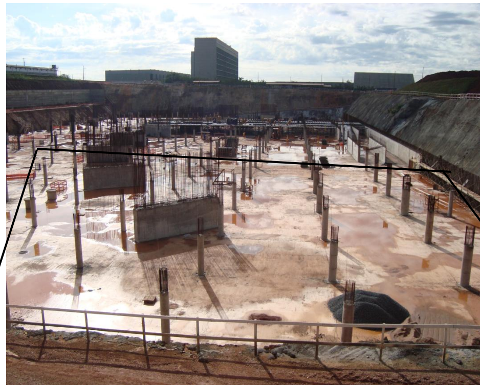
Foto 23 – Concreto Pilares 3º subsolo trecho IV, exceto eixos A e 14, ref. Item Item 03.02.700 no Memorial descritivo
